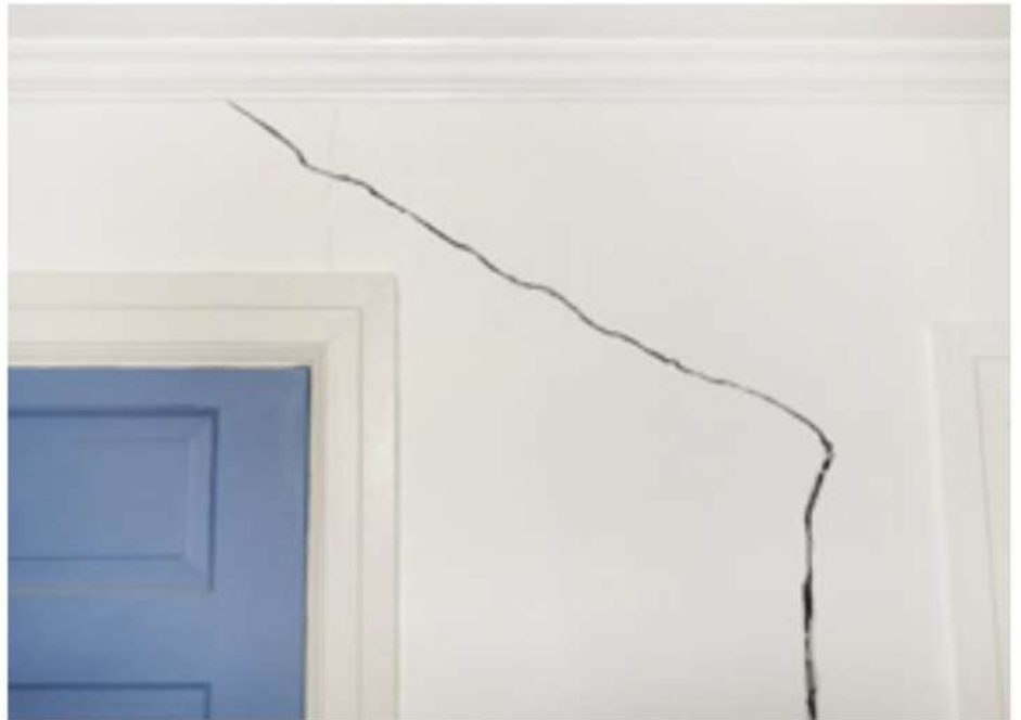
Ein Riss in einer Mauer kann auf ein Erdbeben zurückzuführen sein.
