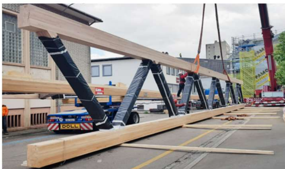
Die drei 36 Meter langen und 4,50 Meter hohen Fachwerkträger wurden liegend auf zwei Tiefladern von Lungern OW nach Basel gefahren.
