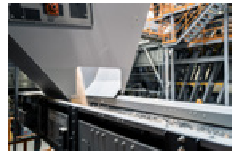
Die von Vecoplan installierte Fördertechnik transportiert das Material im Inneren der Entsorgungslinie kontinuierlich und sicher.
