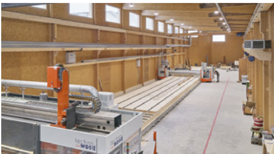
In der neuen, 80 Meter langen Halle produziert «Auprès de mon arbre» mit lokalem Holz Vollholzmodule, aus denen ganze Häuser zusammengesetzt werden. Komplett ohne Schrauben oder Leim. Foto: Yannick Andrea/Schweizer Berghilfe
