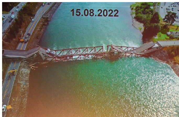
Nach nur zehn Jahren stürzte in Norwegen die Trettenbrücke ein.
